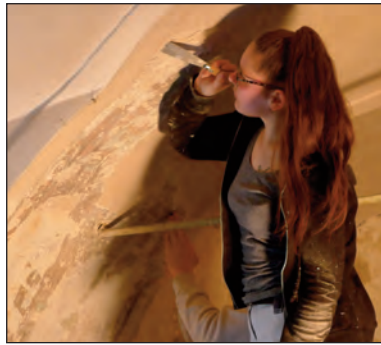
Auch weibliche Auszubildende packen mit an. Hier bei konservatorischen Arbeiten am Dekengewölbe. Foto: Wolfgang Weigl
